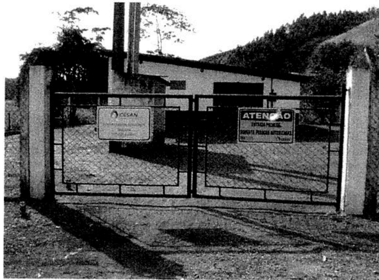
Figura 14: Estação Elevatória de Água Bruta.
